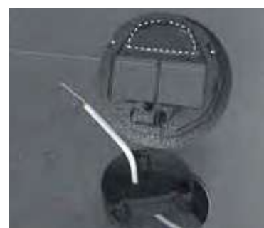
Περάστε τα καλώδια μέσα από την βάση του κουτιού πριν αυτό τοποθετηθεί στο δάπεδο
